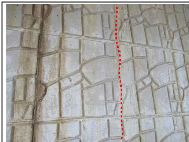
A1 균열 (폭0.2mm)
