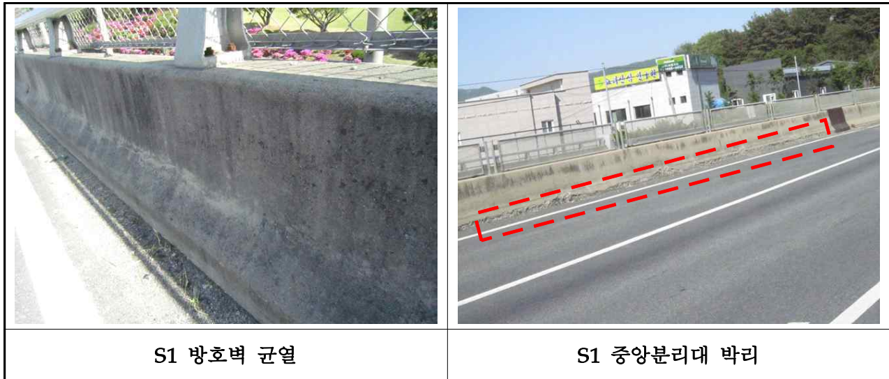
【사진 3.21】 방호벽 및 중앙분리대 손상현황
